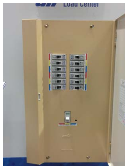
地中配線用分電盤？
